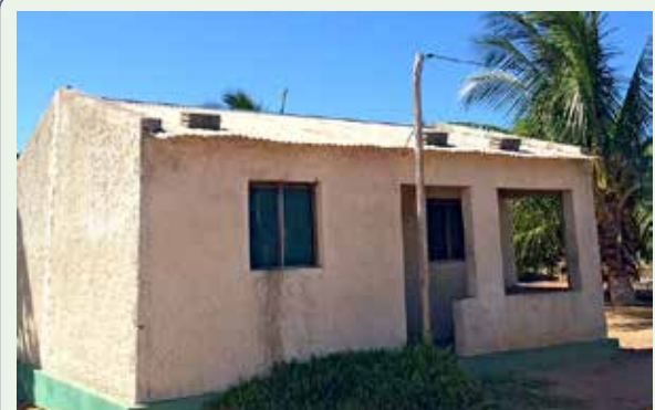
As casas construídas para reassentar as famílias, para além de pequenas, são de construção precária. A cobertura de chapas de zinco começou a ceder. É preciso colocar blocos de cimento para segurar as chapas.
