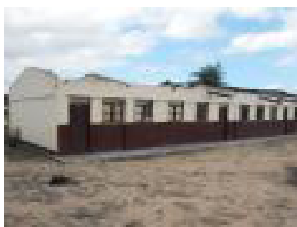
Fig. 5 Salas sem Cobertura no Distrito de Monapo
