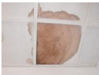
Fig. 2 Infiltração de Água da Chuva – Murrupula
