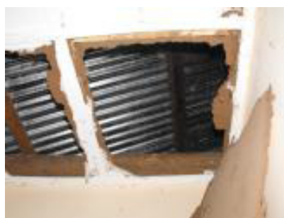
Fig. 1 Tecto Danificado – Distrito de Mandimba (Niassa)
