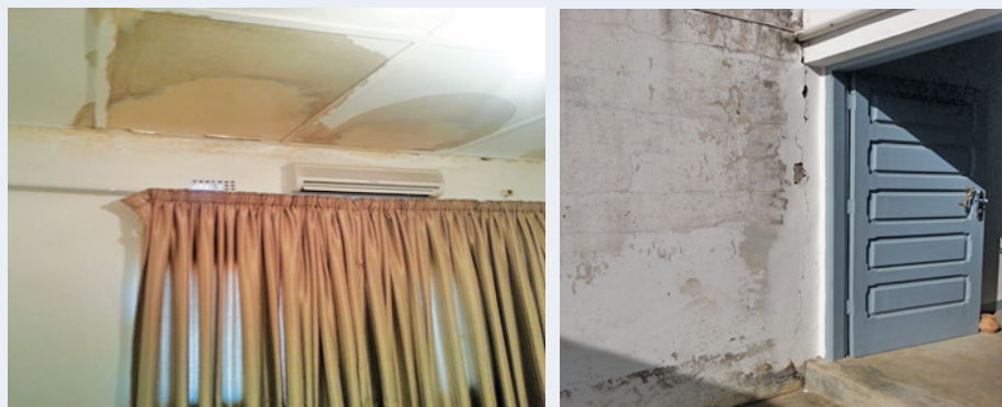
Figura 2: Manchas de Águas Pluviais no Tecto Falso da Residência Tipo III para Funcionários e Rachas na Parede do Tribunal Judicial
