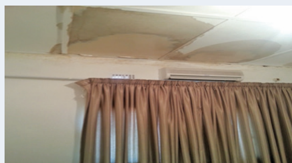
Figura 4: Infiltração de Água da Chuva no Tecto da Residência Tipo III para Funcionários
