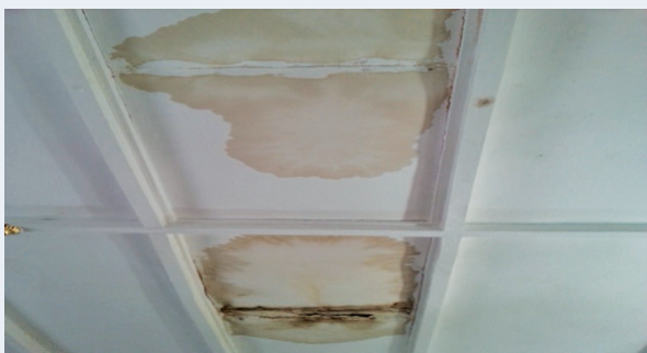
Figura 3: Infiltração de Água da Chuva no Tecto da Residência Oficial do Administrador
