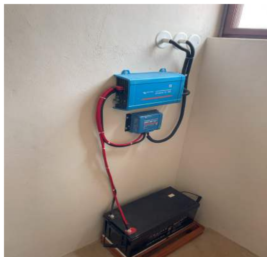
Arrumo onde fica o sistema solar de alimentação eléctrica da casa
