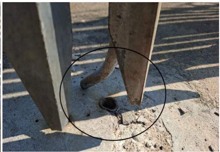
Legenda: Imagem da vandalização da tranqueta da porta de entrada
